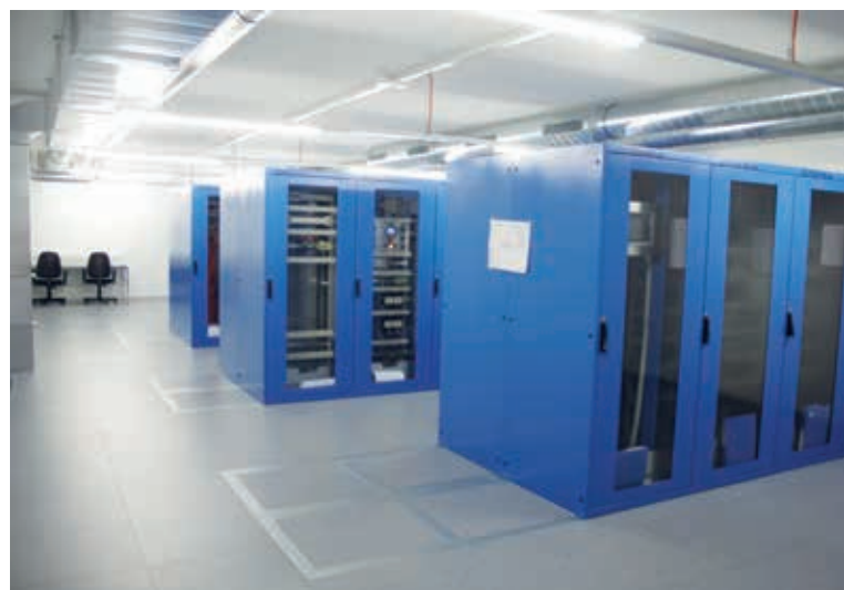
Einer von mehreren Räumen für die Elektronik.
