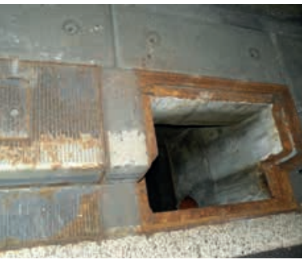
Die alten Schachtabdeckungen sind in einem schlechten Zustand.
