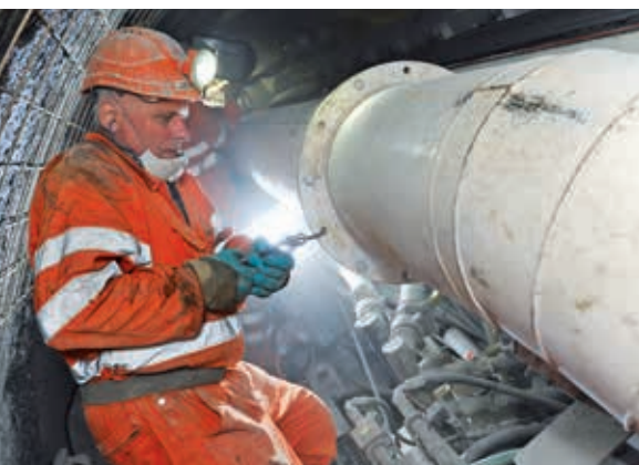
Im Tunnel ist es eng, staubig und laut. Umso wichtiger ist gute Zusammenarbeit.
